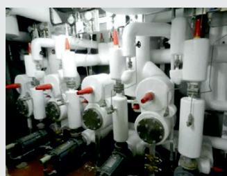
TUBERÍAS DE FRÍO
